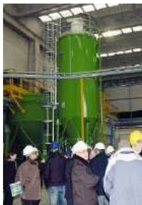
Innovativo impianto di stoccaggio e trattamento dei materiali realizzato da Econord
